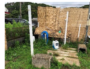
シャワー設備
